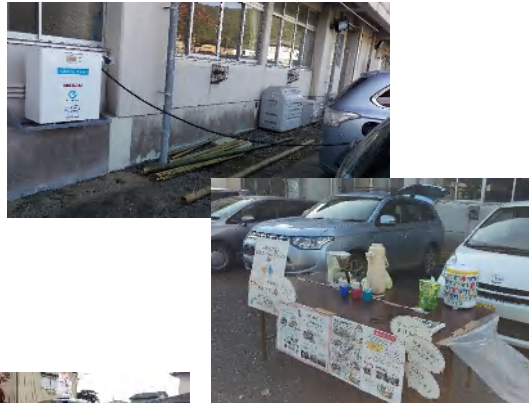
鹿妻小学校におけるV2Hシステム
